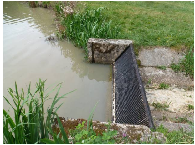
Photo 4 : Grille à l'entrée de la surverse
