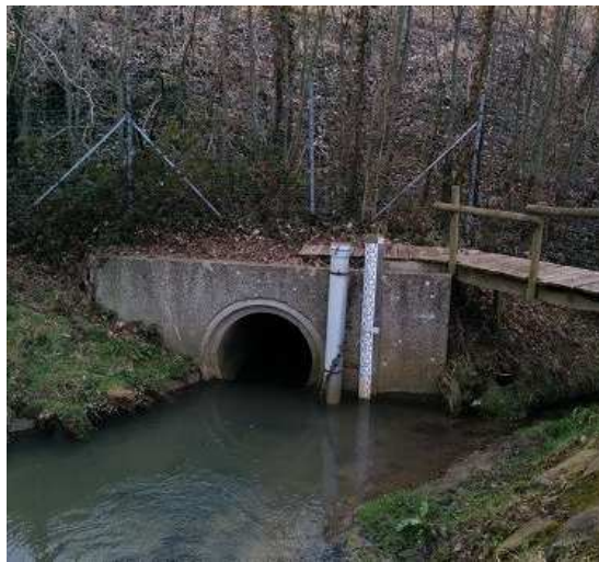
Photo 13 : Exemple d'échelle limnimétrique équipant un ouvrage
